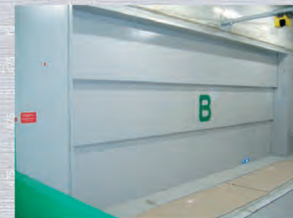
立体駐車場入り口ゲート
